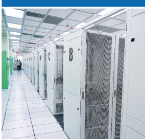
穩固及安全的IDC雲端機房
