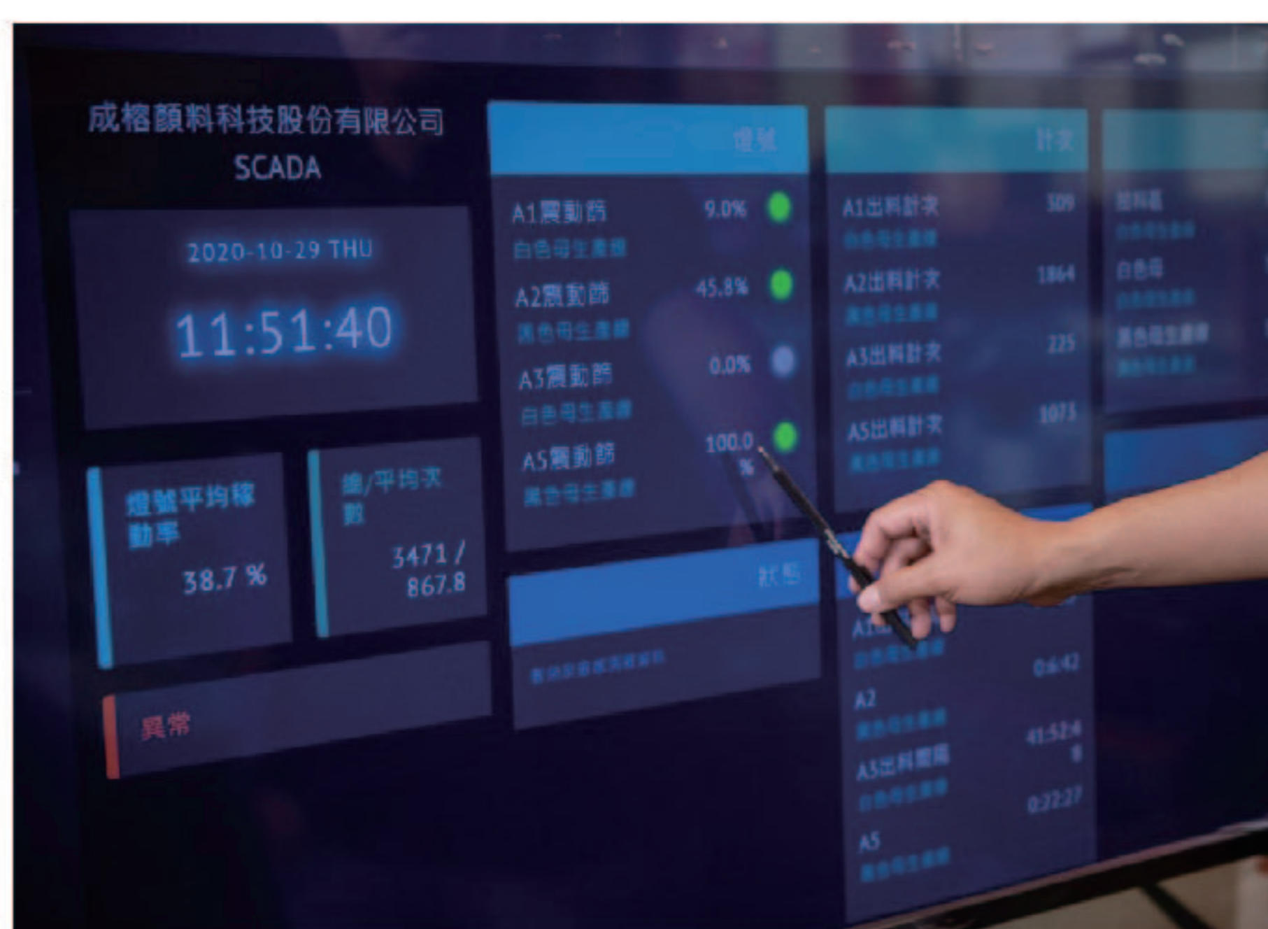
▲ 能夠及時掌控生產線運作狀況、能在辦公室或手機即時監看廠房設備的運作狀態
